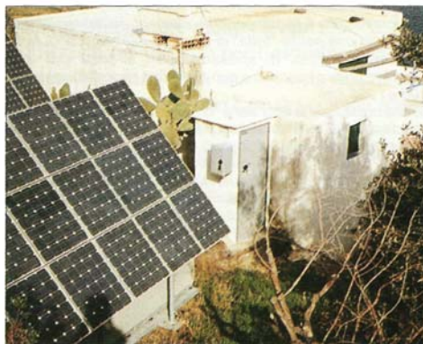
Celle fotovoltaiche utilizzate per alimentare utenze isolate (Isole Eolie).
